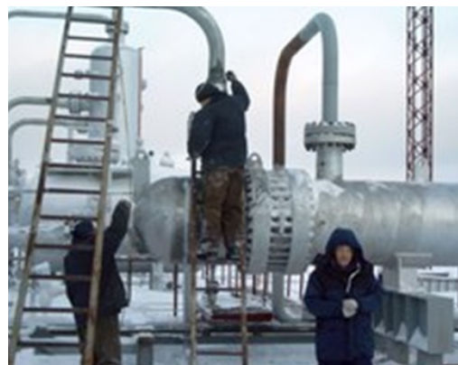
Обслуживание теплообменника скважины Ярактинского месторождения. (Иркутская обл.).
