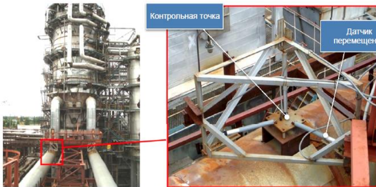
Датчики перемещений трансферных трубопроводов
